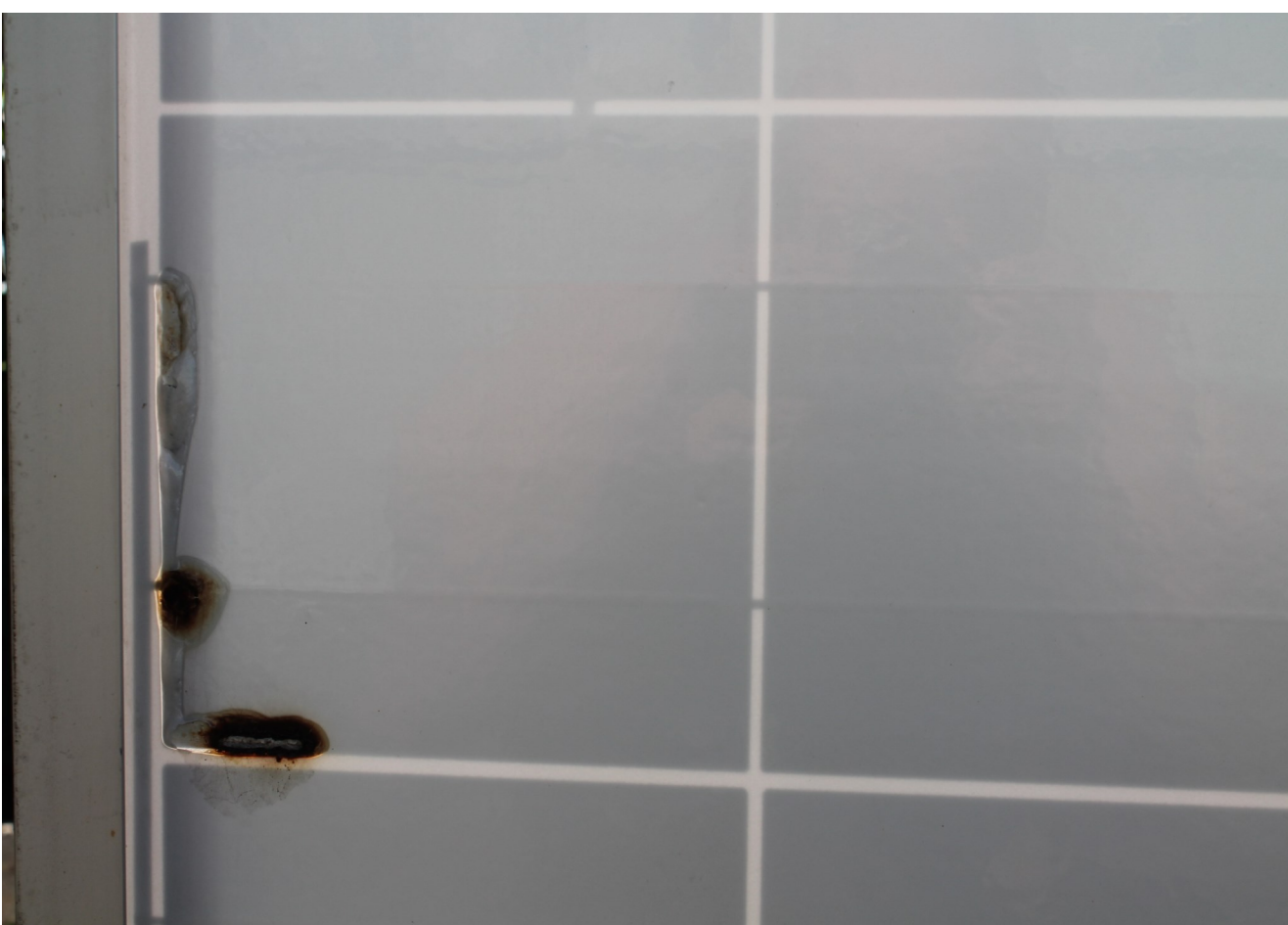
Cellule ayant chauffé jusqu'à la combustion. (Labo ITAQ OI)
